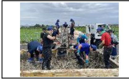
工業科：汚泥槽の清掃
