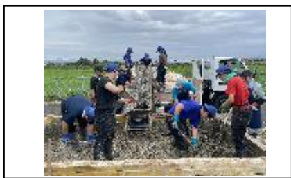
工業科：汚泥槽の清掃
